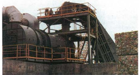
熱風循環式キルンシステム(全景)
